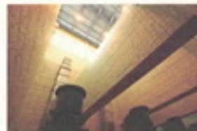
สถานีสูบน้ำพระโขนง ติดตั้ง Cylence ตราช่าง สีดำบนผนัง ดูดซับเสียง รุ่น Zoftone
